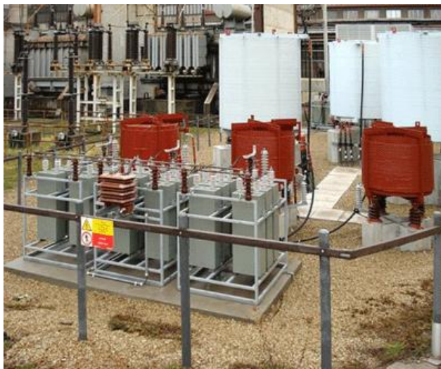
Рис. 5.8. Місце розташування на підстанції
